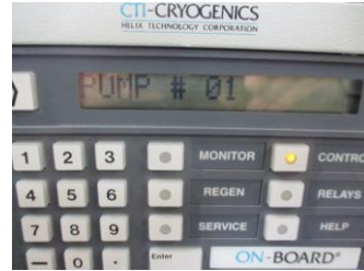
PUMP動作時表示
